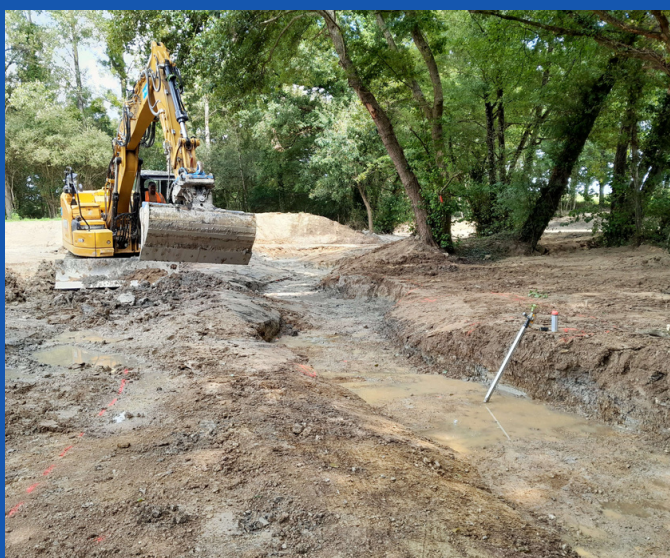
Réalisation du nouveau lit du cours d'eau situé entre les deux anciens plans d'eau
