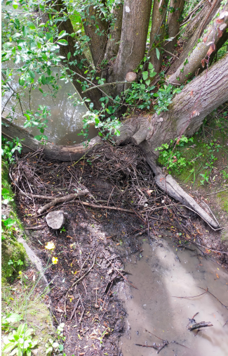
embâcles à supprimer obstruction totale du lit
