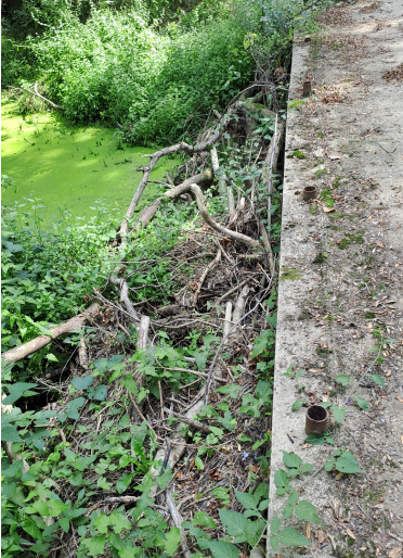
embâcles à supprimer (endommagement ouvrage)
